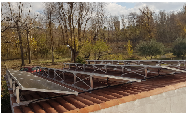
/ Vista de los módulos fotovoltaicos de la instalación sobre tejado
